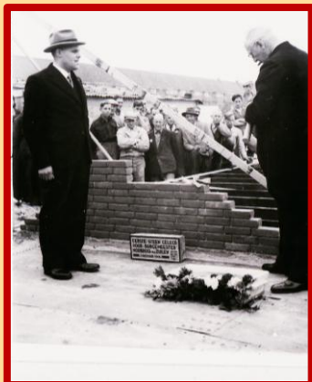
Van Hoorn (met hoed) kijkt toe bij de voorbereiding voor het leggen van de eerste steen door burgemeester O. Norbruis. Deze steen zit in de linkerwoning van het rijtje aan de Adriaan Mulderstraat
